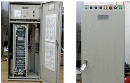
本体内部及び施錠部
